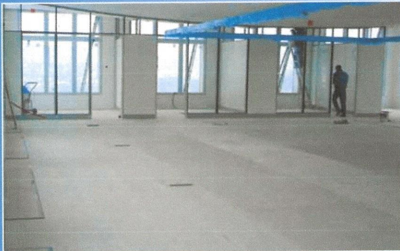
MERO Hohlboden Combi T im Barmenia Bürogebäude
